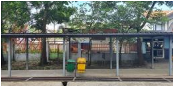
Gambar 4. Atap dengan penutup atap asbes sumber : dok penulis, 2023
