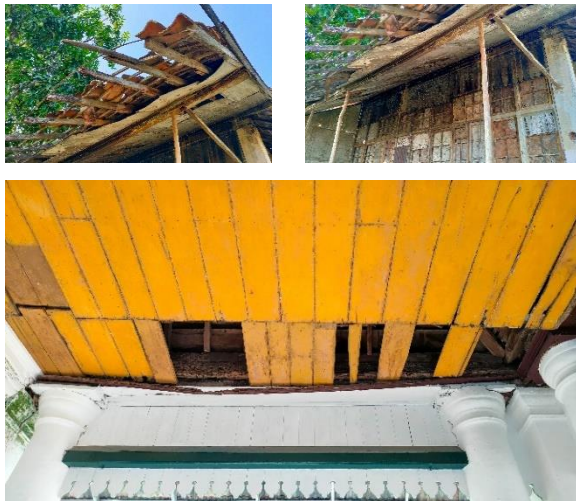
Gambar 7. Jenis Kerusakan Material Kayu Sumber: Dokumentasi Pribadi
