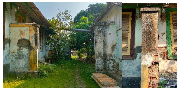
Gambar 10. Jenis Kerusakan Pada Dinding Sumber: Dokumentasi Pribadi
