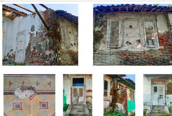
Gambar 9. Jenis Kerusakan Pada Bangunan Sumber: Dokumentasi Pribadi
